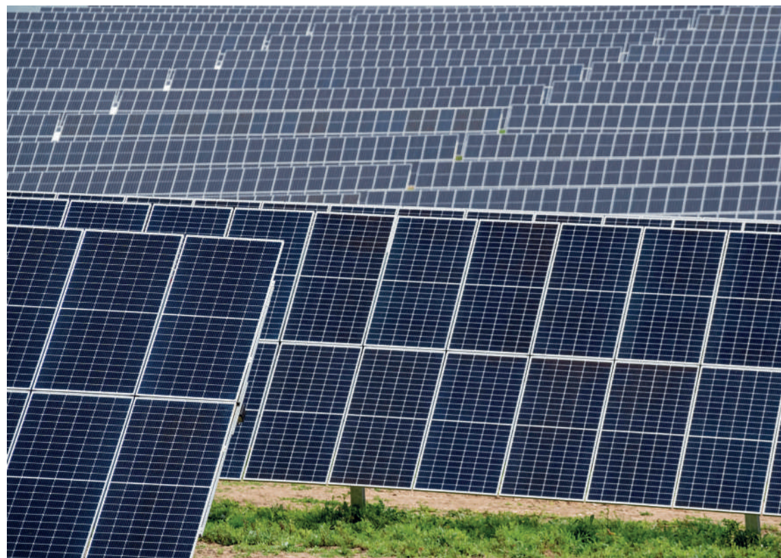
Planta de 50 MW en Posadas (Córdoba) desarrollada por IBOX ENERGY.
