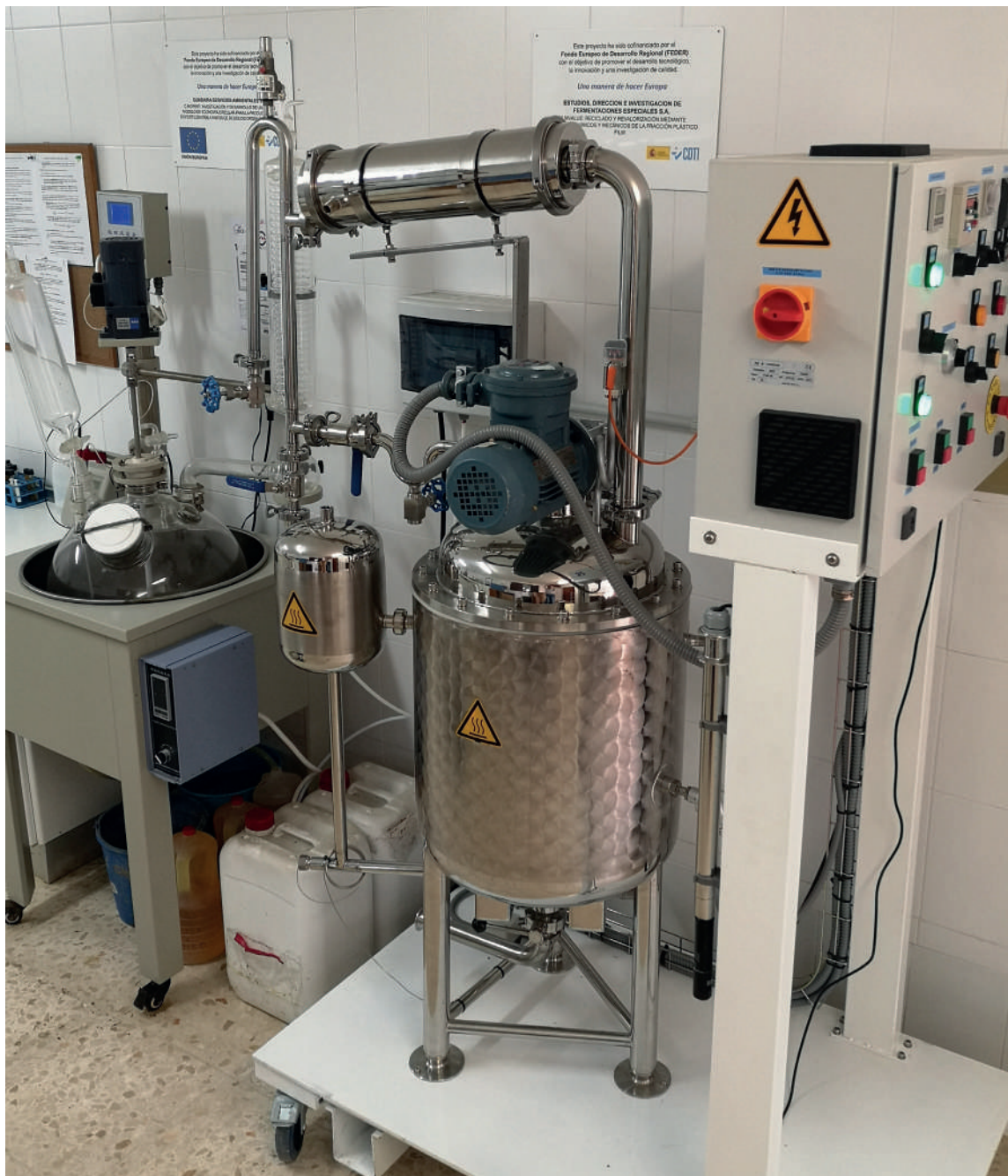
Reactores de laboratorio para desarrollo de tecnologías instalados CITRSU Montemarta Cónica.
